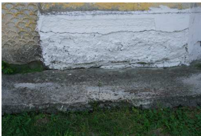
Degradări la nivelul soclului: intervenții necorespunzătoare care maschează degradările
