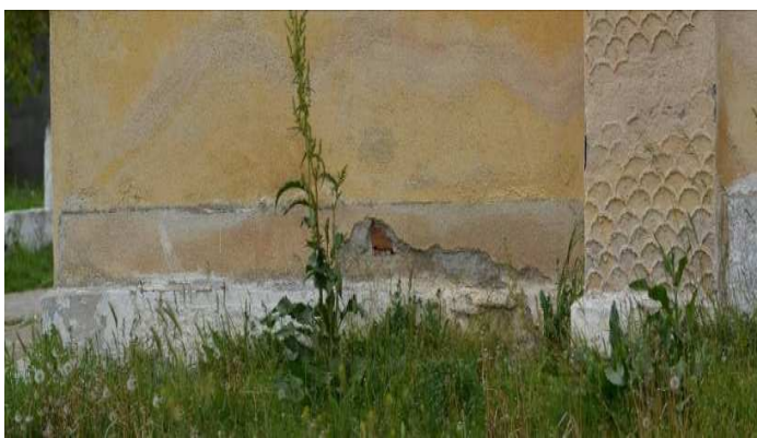
Degradări la nivelul soclului: intervenții necorespunzătoare, degradarea tencuielilor
