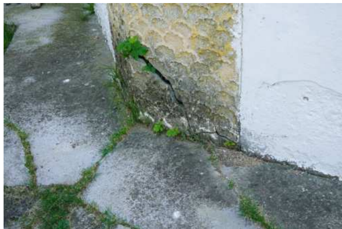
Degradări la nivelul soclului: intervenții necorespunzătoare
