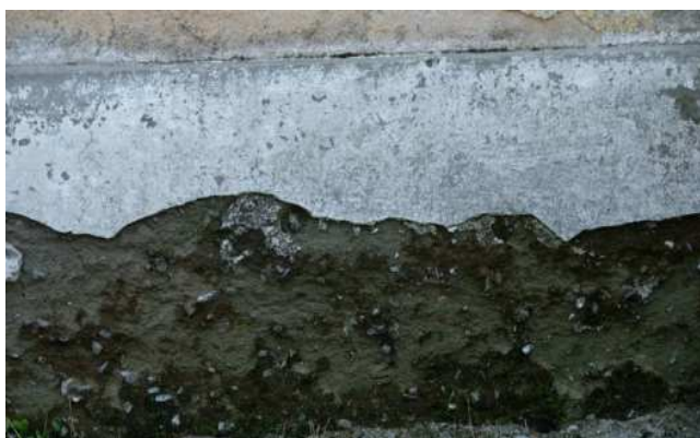
Degradări la nivelul soclului: atac biologic
