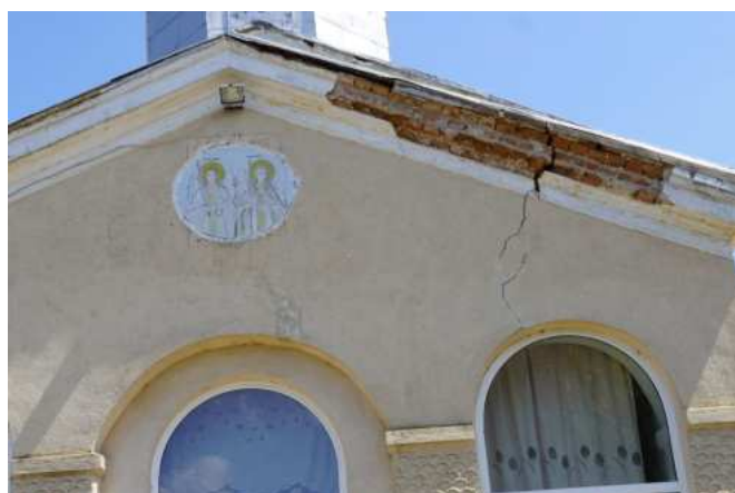
Fațada de vest, fisuri și lacune profunde
